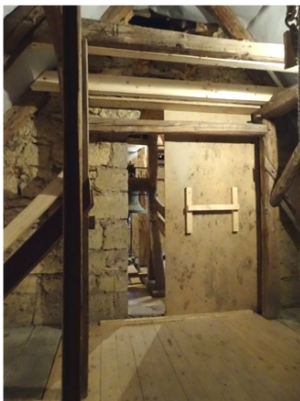
Bild 2. Schiebetür, die das Langhaus von der Turmstube fledermausdicht abtrennt
