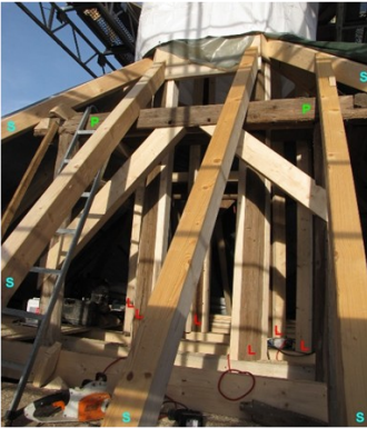
Tragwerk des Turmdachs von Süden: Die inneren 6 Laternenstützen (L, seitliche Verstärkung mit neuem (hellen) Holz, sind von einer viereckigen Pfettenkonstruktion (P) umgeben, auf der die Sparren (S) ruhen. Durch die starken Holzschäden mussten viele alte Balken durch neue ersetzt werden.
