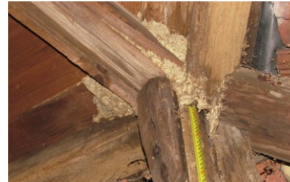
Bild 1: Turmstube Wespennestbau eines „Dunkelhöhlennisters“
