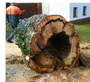
Das vom Kommunal-service Jena dem Oberbürgermeister-schreiben beige-fügte Bild zeigt die „erheblich fortgeschrittene Fäule“ der Linde.
