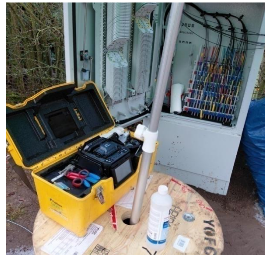
Verteilerkasten mit den einzelnen Glasfasersträngen, die jeweils über eine Spleißkassette (die in der Schranktür übereinander geschachtelten Plasteteller) mit dem Kunden verbunden sind. Im gelben Plastekasten befindet sich ein hochpräzises Lichtbogenschweißgerät, mit dem das Kundenkabel mit dem Stammkabel verbunden wird.
