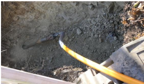
Die angesteuerte Zwischengrube ist erreicht, und das gelbe Trägerkabel am Bohrgestänge befestigt.
