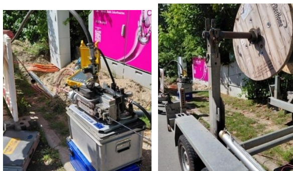
Verteilerstation an der Einmündung des Mühlenweges in die Straße vor dem Grünlaube. Die Kabelrolle, rechtes Bild, kann sechs km Kabel aufnehmen. Dieses Kabel wird gerade in den Hauptstrang eingeblasen. Es hat einen Ø von 6,5 mm, enthält acht Bündel mit je zwölf Einzelsträngen (96) und kann somit fast hundert Anschlüsse bedienen. Links im Bild ein MicroJet-Gerät. Das Glasfaserkabel, das den Verteilerkasten mit dem
