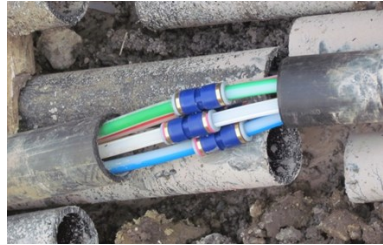
Blick in die Baugrube am „Grünen Baum“. Leer-Rohre mit Bündeln von Glasfaserkabeln.
