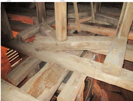
Verfauter Unterzug in den Deckenbalken der Glockenstube (die beidseitig parallel laufenden Balken gehören zum Glockenstuhl); Starke Schäden wurden auch beim 6-eckigen Auflager der Laternenstützen festgestellt.
