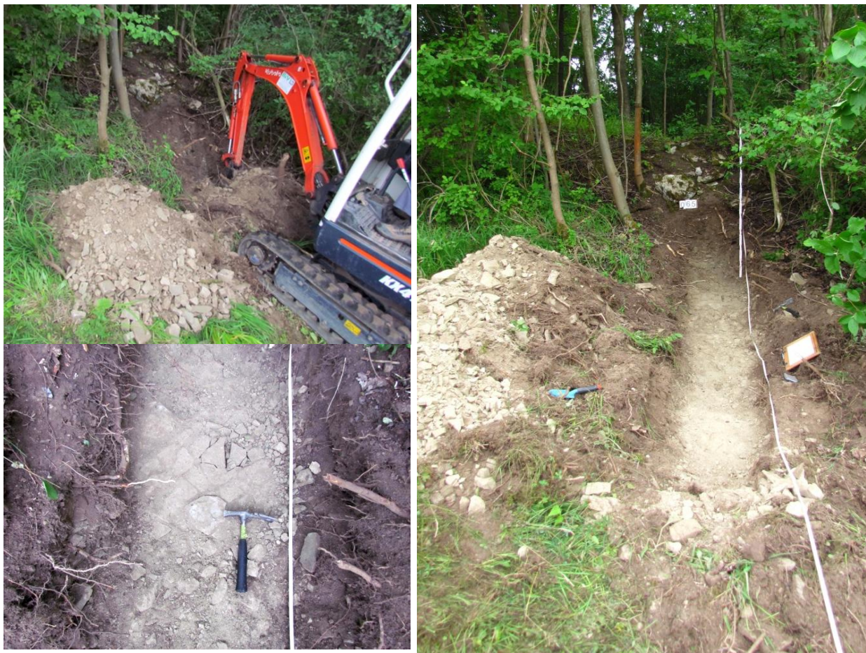
4.1-7 Baggerschlitz BS 1 . Links unten- Blick auf die Schichtflächen des plattig ausgebildeten Schaumkalks \chi 2 . (Schichtung ss 32/13° NW).
